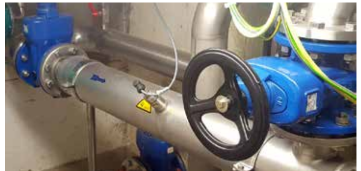
Vgradnja UV dezinfekcije zagotavlja kakovostno pitno vodo na viru.
