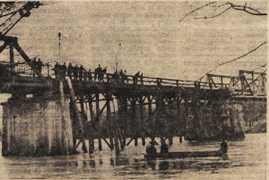
Začetna dela na gradnji metliškega mostu močno ovira narasla Kolpa, vseeno pa izvajalec del, podjetje Tehnogradnja iz Maribora, uspešno kljubuje deroči reki. (Foto: R. Bačer)
