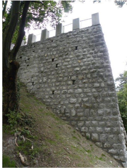
Slika 206: Irena Vesel Kopač: Šance, sanirani del zidu pod malo teraso Foto: ZVKDS, OE LJ, 2014
