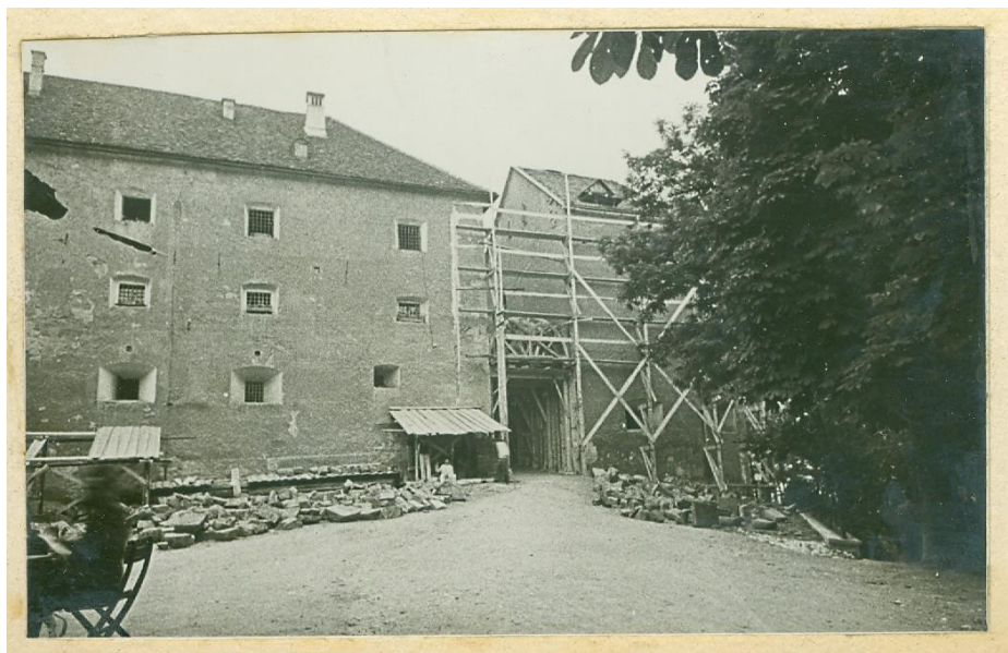
Slika 38: Ljubljanski grad, prenova glavnega vhoda, 1941 (?) Nahajališče: Iz arhitekturne zbirke MAO, arhiv arhitekta Borisa Kobeta
