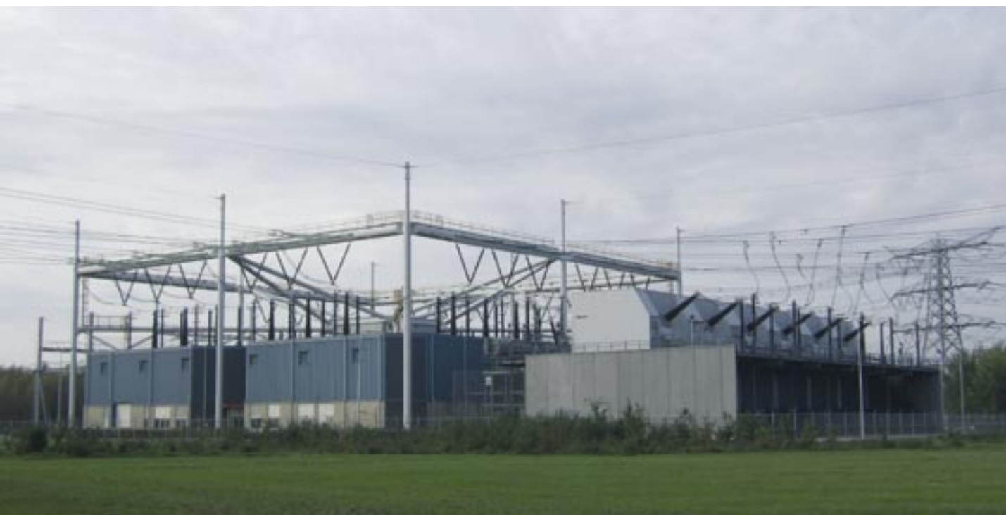
Transformatorska postaja Meeden s prečnimi transformatorji.
