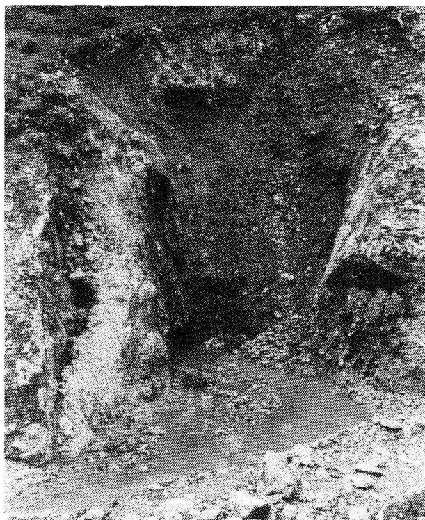
Sl. 4: Izvir Kajža II med gradnjo zajetja. Voda priteka iz zasutega kraškega rova ob robu 3 do 4 m široke pretrte cone v spodnjekrednem apnencu. Foto: Jože Janež
