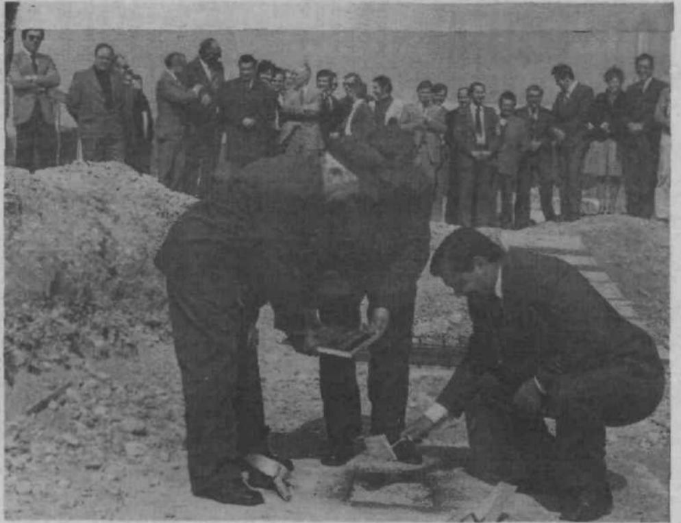
NOVA TOVARNA IMP – Janez Brajer, predsednik delavskega sveta tozda ogrevanje in vodovod Industrijskega montažnega podjetja, je vzdal temeljni kamen za nove prostore v industrijski coni na Črnučah, kjer bo obrat cevovodov. Investicija bo veljala 120 milijonov dinarjev.
