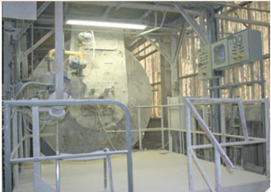
Novo stanje opreme na gorilniku peči
