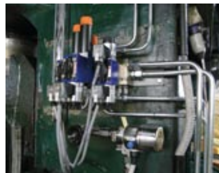
Vgrajena hidravlična oprema
