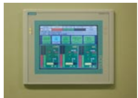
Krmiljenje gorilnika kalcinacijske peči
