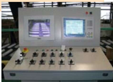
Del elektro opreme in nov krmilni pult
