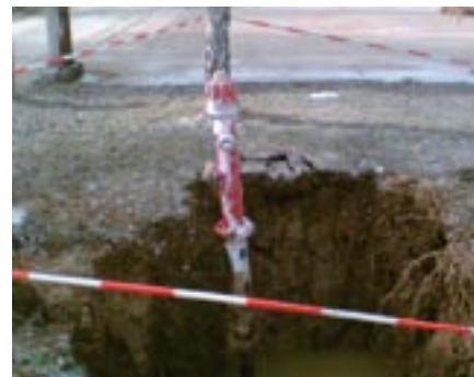
Defekt hidranta pri nevalizaciji
