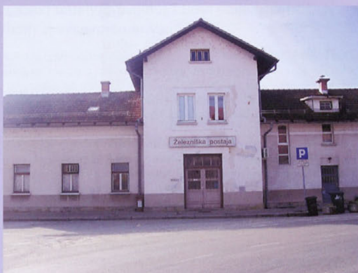
Železniško postajo Medvode bi bilo treba obnoviti. Večja vzdrževalna dela letos niso predvidena.
