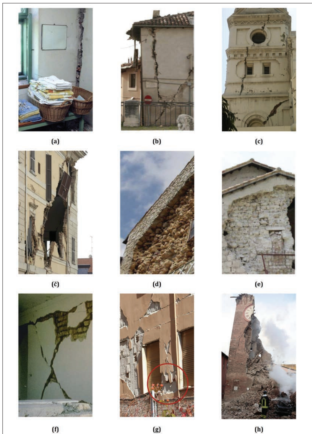
Slika 1: Tipične poškodbe zidanih stavb zaradi potresne obremenitve: (a) razpoke na stiku zid-zid, (b) ločevanje nepovezanih zidov, (c) navpične razpoke v zidovih, (č) padanje zidu iz ravnine, (d) in (e) razslojevanje zidu, (f) diagonalne razpoke, (g) upogibna porušitev slopa ob oknu ter (h) porušitev stavbe (Vir: Petrovčič, 2013).
