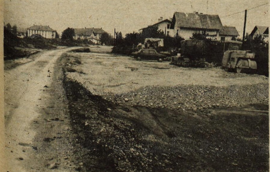
Cestno podjetje Kranj in Gradbeno podjetje Trzin razširjata Cesto talcev proti kranjskem pokopališču. Razširitev ceste, ki bo imela tudi podhod za pešce, sodi v program ureditve novega stanovanjskega naselja na Planini v Kranju. Investitor teh del je podjetje Dom plan Kranj. Rok za dokončanje del na cesti je 1. november letos. — A. Ž. — Foto: F. Perdan
