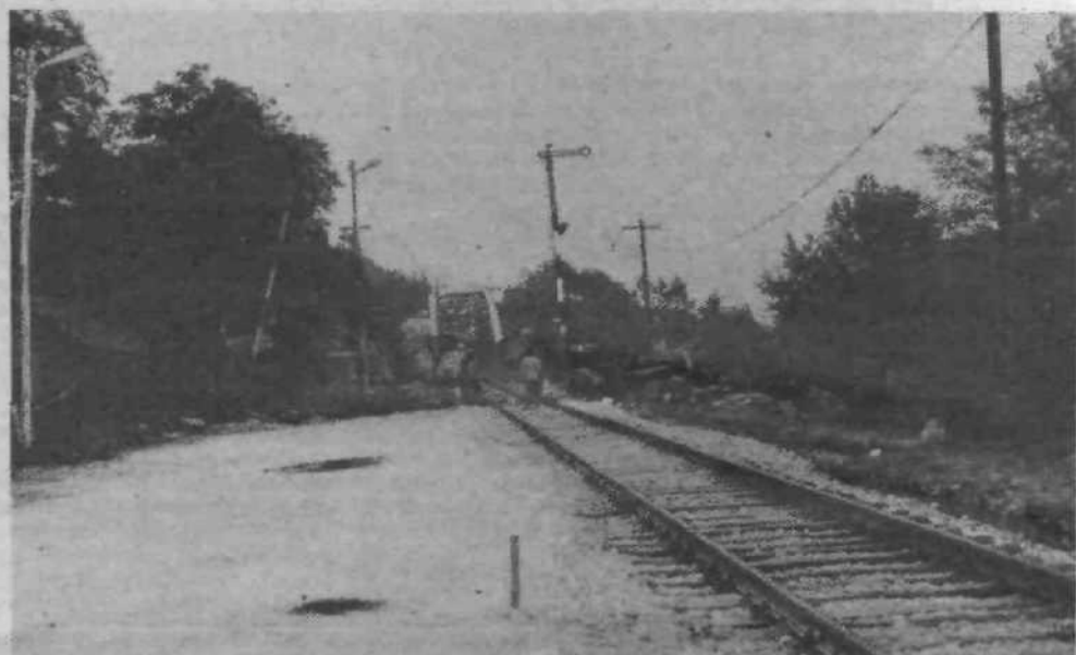
Čez dan ali dva bodo začeli z obnovo še precej dotrajanega črnuškega mostu čez Savo. Tovarnjaki bodo do konca oktobra, ko bo obnova predvidoma končana, vozili skozi Tacev ali Šentjakob, osebni avtomobili pa bodo v eni smeri vozili preko starega črnuškega mostu, v drugi smeri pa si bodo delili »življenjski prostor« s »Kamničanom«, saj bo promet spajen preko železniškega mostu (na sliki). Za začetek del je že vse nared, gneča na cesti pa bo zdaj prav gotovo še hujša, kot smo je vajeni ob prometnih konicah, zato se najbrž tudi voznikom osebnih avtomobilov spleta zapeljati do Šentjakoba ali Tacev.
