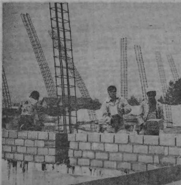
S sredstvi iz drugega samopriskpeva bo zrasel ob Dečkovi ulici vzgojni zavod Janeza Levca. Gradi ga SGP Graditelj iz Kamnika. Objekt bo dograjen maja prihodnjega leta.
