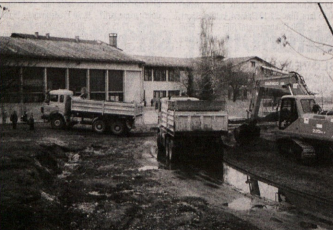
V DELU NOV STADION - Delavci Kostaka naj bi pri osnovni šoli Šentjerneje že pred mesecem in pol začeli graditi nov stadion. Začetek del se je zavlekel zaradi težav pri pridobivanju soglasij, vendar so stroji v začetku prejšnjega tedna le začeli delati. Stadion naj bi bil končan konec maja, a verjetno se bo zaradi odloženega začetka tudi konec nekoliko zavlekel. Nov stadion bo večji od prejšnjega, atletska steza bo dolga 300 metrov in prevlečena z umetno maso, v sklopu stadiona pa bodo tudi igrišča za potrebe šole. Športni objekt bo ograjen, v bodoče pa bo, vsaj takšna so predvidevanja, tudi razsvetljen in bo imel tribune. Naložba je vredna 143 milijonov tolarjev. Za letos je v državnem proračunu še rezerviranih 12 milijonov, v občinskem pa 30 milijonov. Kako bo s financiranjem prihodnje leto, še ni znano. (Foto: T. Jakše Gazvoda)
