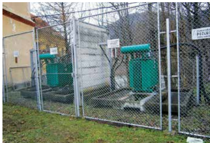
Dva generatorja po 0,5 MW moči, pogon preko prenosa, ki ju poganjata dve turbini iz leta 1929
