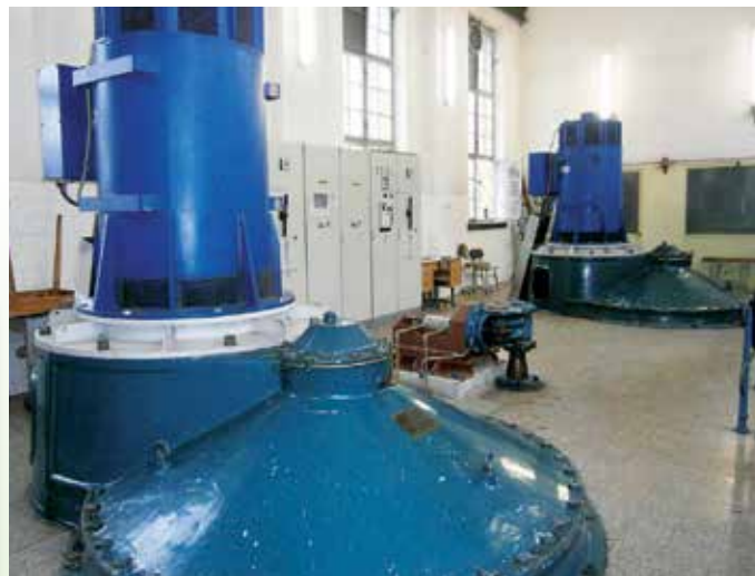
Elektrarna, priključena direktno na elek. omrežje
