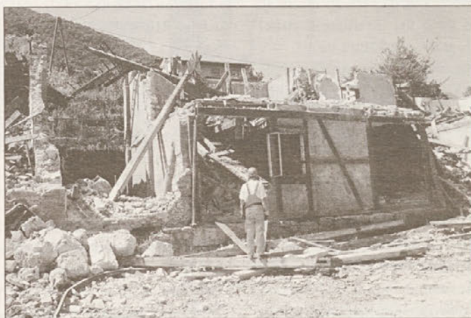
"Žive" ruševine na Kopalški ulici je zelo spominjala na resnične situacije lanskega poletja v Turčiji (slika MM)
