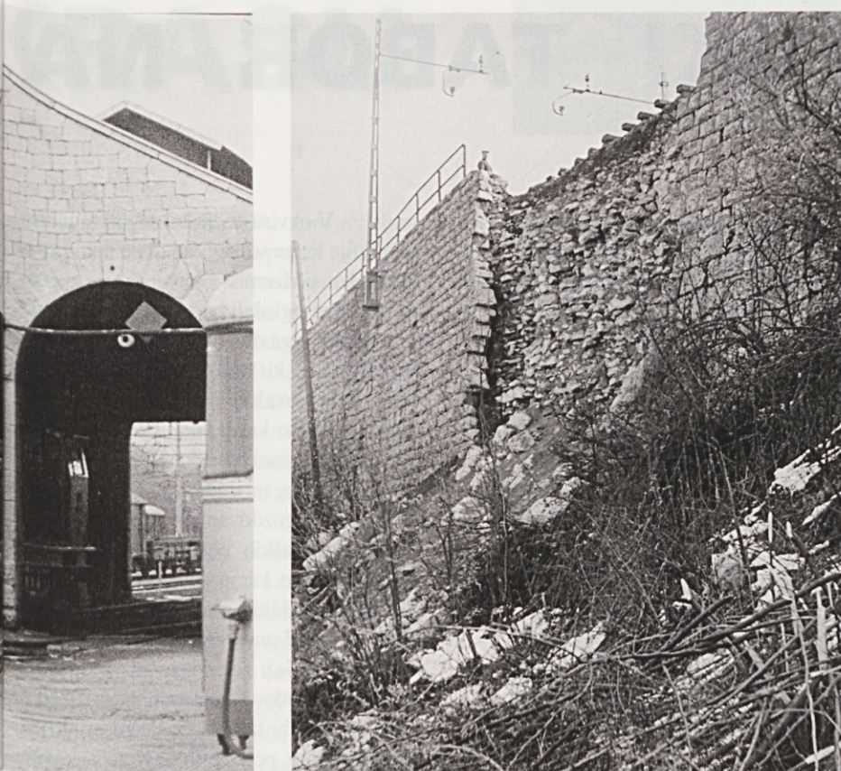
Podporni zid pri Štampetovem viaduktu je dotrajan. Načel ga je zob časa... Fotografija je iz leta 1961. Vse slikovno gradivo je prispeval K. Rustja.
