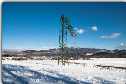
Slika 15: Na cesti med Postojno in Grobiščem je žled poškodoval daljnovod (Vir: Blatnik, 2014).
