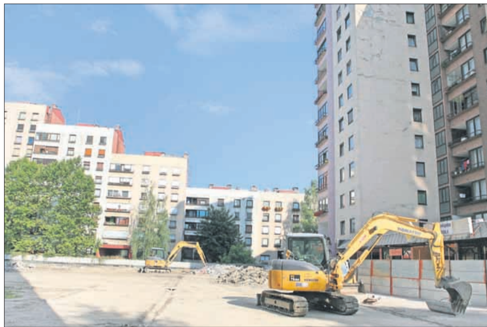
Zaradi znanih zapletov v Vegradu so bila avgusta obnovitvena dela na Kardeljevi ploščadi začasno prekinjena.
