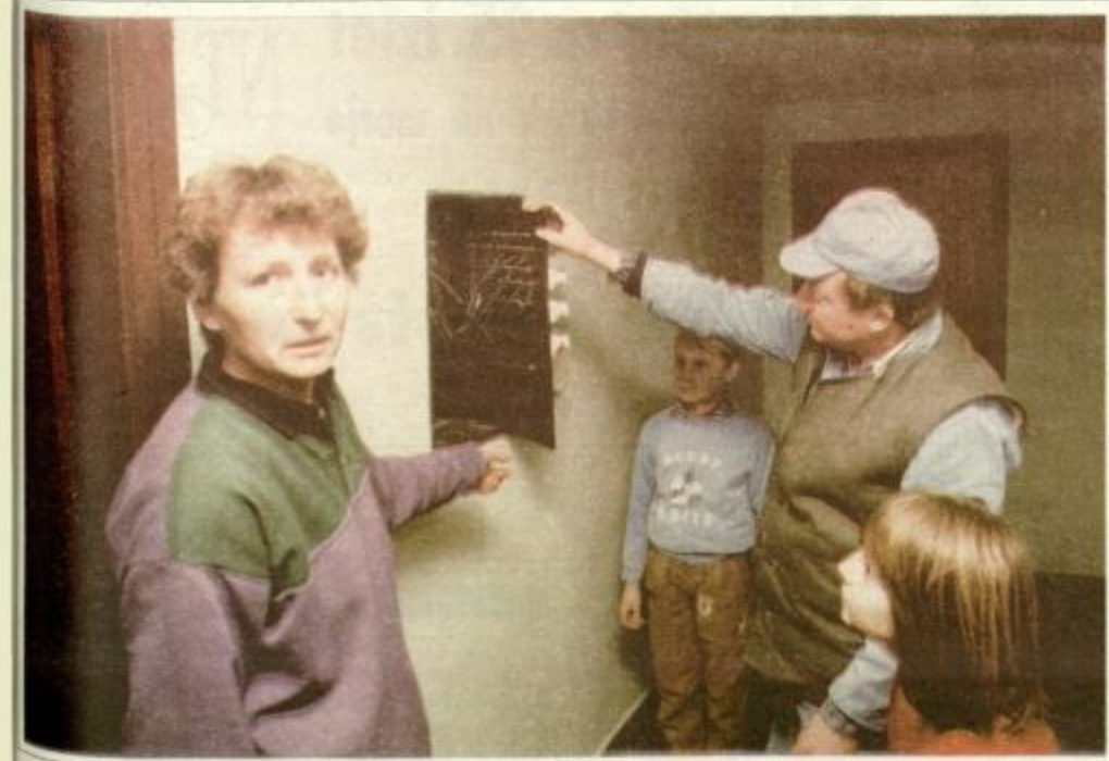
Velika sila je izruvala tako notranjo kot tudi zunanjo električno omarico.
