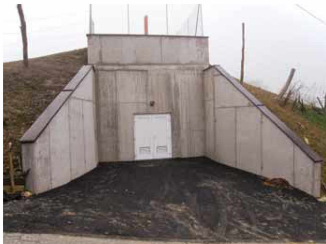
Vodohran v Motovilcih (foto: Matej Gumilar)
