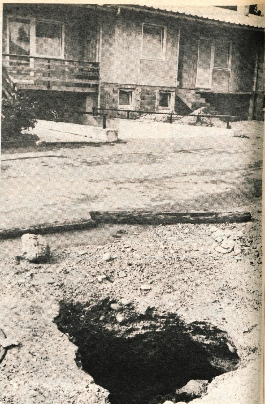
V naselju montažnih hiš na Kokrici so spet zazijale velike in nevarne luknje ter vzemirile prebivalce. Gornji posnetek je bil narejen lani in objavljen 6. septembra v 69. številki Glasa. Nove zemeljske »kaverne« namreč niso nič manjše od lanskih na fotografiji. – Foto: F. Perdan
