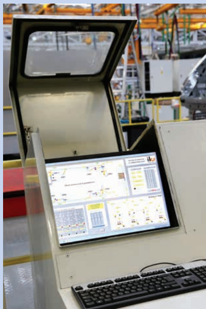
» Računalo središnjeg kontrolnog sustava
