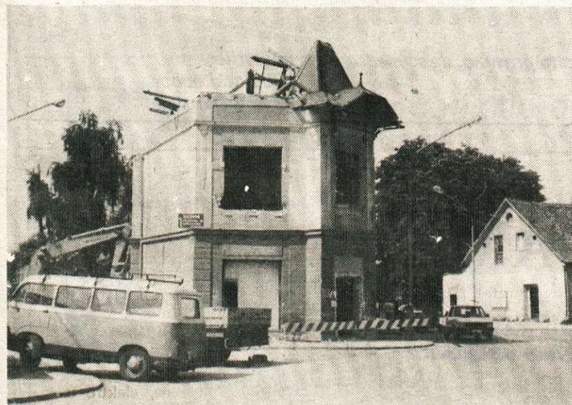
Turkova hiša iz obdobja secesije tesarskega mojstra Franca Ravnikarja iz Ljubljane je tudi že preteklost. Graditi znamo, rušiti pa še bolje.
