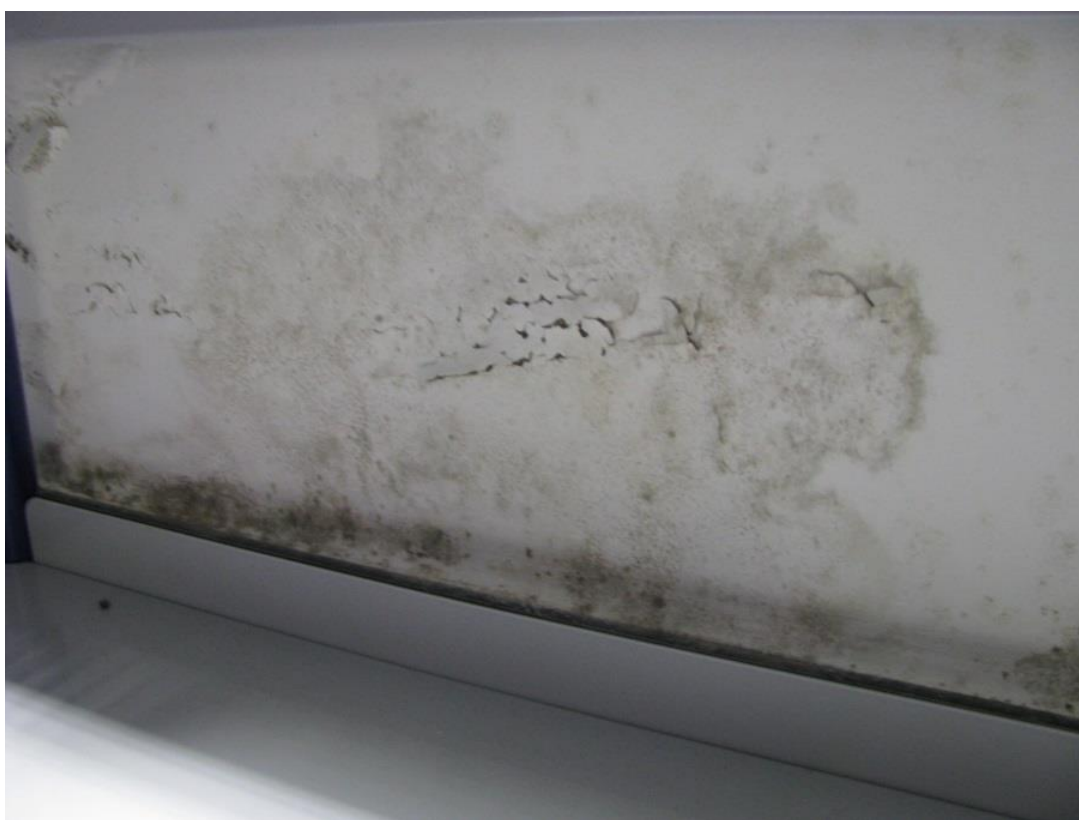
Slika 5: Poškodbe zidu zaradi solitra in plesni
