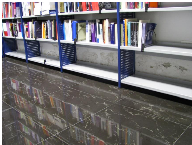
Slika 6: Poškodbe sten zaradi plesni in solitra
