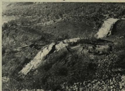
Slika 4: Cesta po zdrsnitvi. Pogled od severovzhodnega roba plazu proti jugozahodu.
