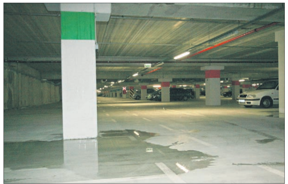
Mestna občina Velenje bo parkirna mesta pod Mercator centrom končno odplačala januarja. V garažni hiši so sicer imeli precej težav z zamakanjem, ki so jih odpravili poleti. Pred kratkim je bilo na parkiriščih spet precej vode, vendar ne zaradi zamakanja, ampak zaradi vandalov, ki so odprli hidrant. Tudi zaradi vandalizma razmišljajo, da bi na teh edinih brezplačnih parkiriščih vendarle začeli zaračunavati parkirno in s tem poskrbeli za varovanje.
