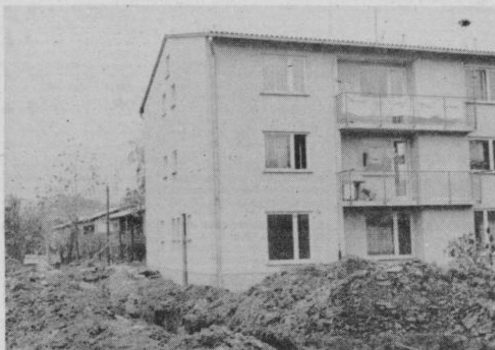
Napeljava od kotlovnice do stanovanjskega bloka upokoencev še ni povsem gotova, zato lahko še pričakujejo motnje pri ogrevanju.
