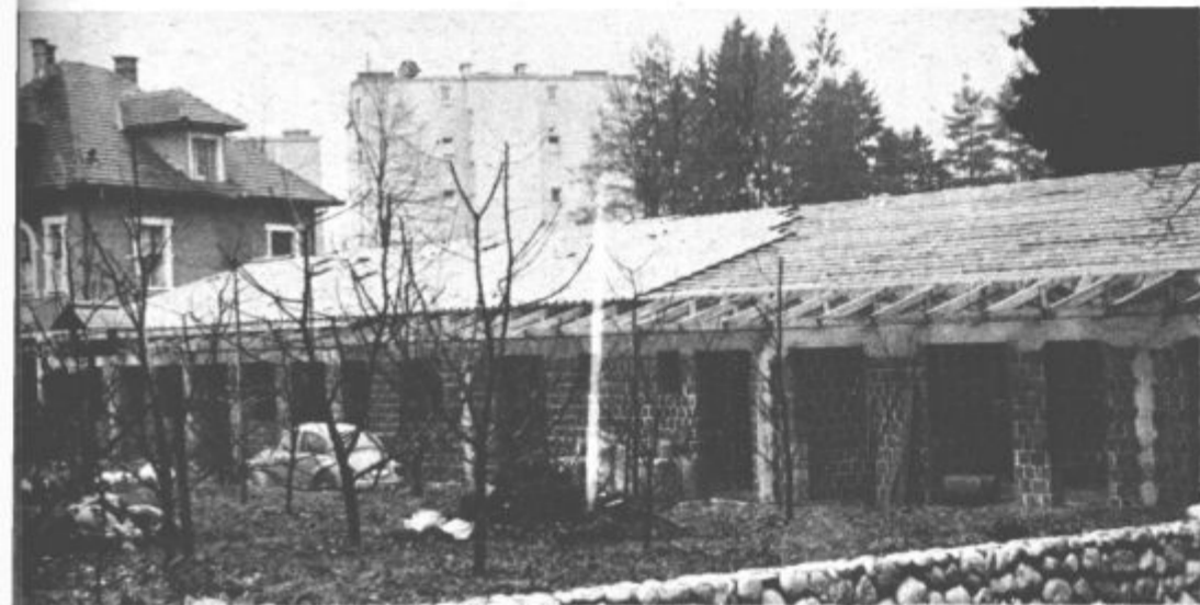
Dela pri gradnji prizidka vrta Kekec v krajevni skupnosti Velenje - Center desni breg dobro napredujejo. Zgradbo te dni prekrivajo. Vrtec Kekec bo sprejel 120 otrok, v kuhinji pa bodo lahko pripravili 500 obrokov. S staro zgradbo ga bo povezoval hodnik.
