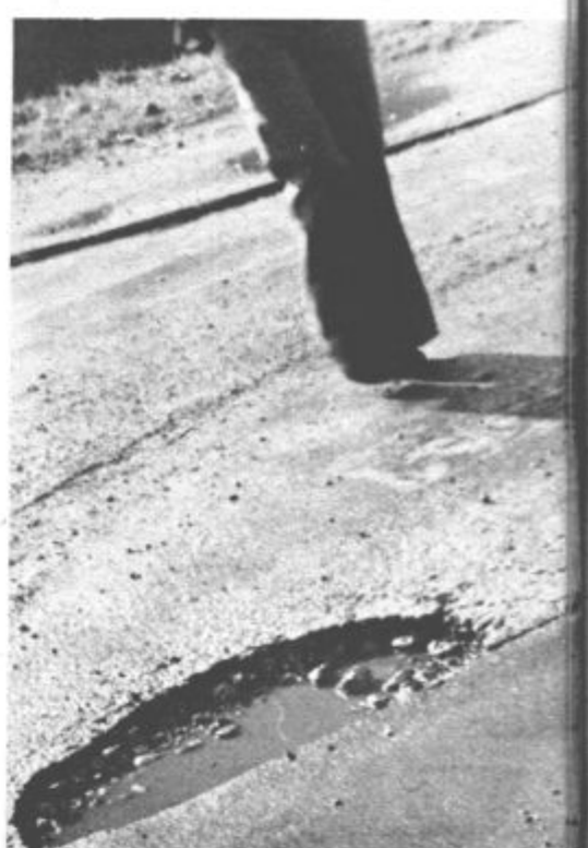
LUKNJE, LUKNJE, LUKNJE... V teh zimskih dneh so naše ceste, žal, polne tako „nedolžnih“ lukenj. Zlasti bogate so na Celjski cesti in zato povzročajo jezo marsikaterega voznika, ko nenadoma zapelje vanjo. Pri tem trpijo kolesa, peščil, če so slučajno blizu in jih malce poškrbijo, pa tudi delavci komunale, če jih neprestano krpejo...
