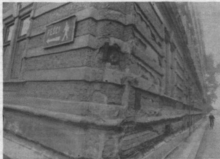
Na vogalu Rimske in Kardeljeve ulice lahko vidimo takšno podobo razpadajoče stene. Krivda je bržčas na gostem prometu, ki poteka tesno ob hišah in brzga curke vode na hišno pročelje. Kdo je v resnici odgovoren in koliko časa še? Podoba, kjer je vsak dan tudi veliko tujih obiskovalcev našega mesta, je vse prej kot prijetna.
