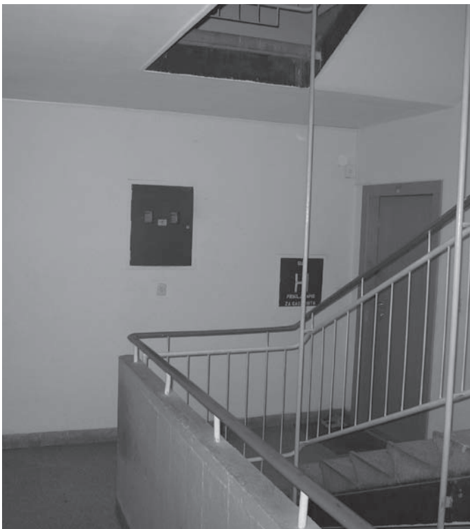
Slika 5: Odprto stopnišče z lesenimi vhodnimi vrati ne ustreza današnjim zahtevam protipožarne varnosti stanovanjskih stolpnic.
