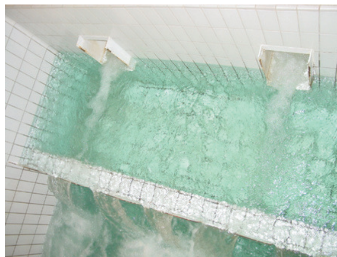
Slika 22 • Obrežni filtrat na iztoku iz lamelnih usedalnikov.
