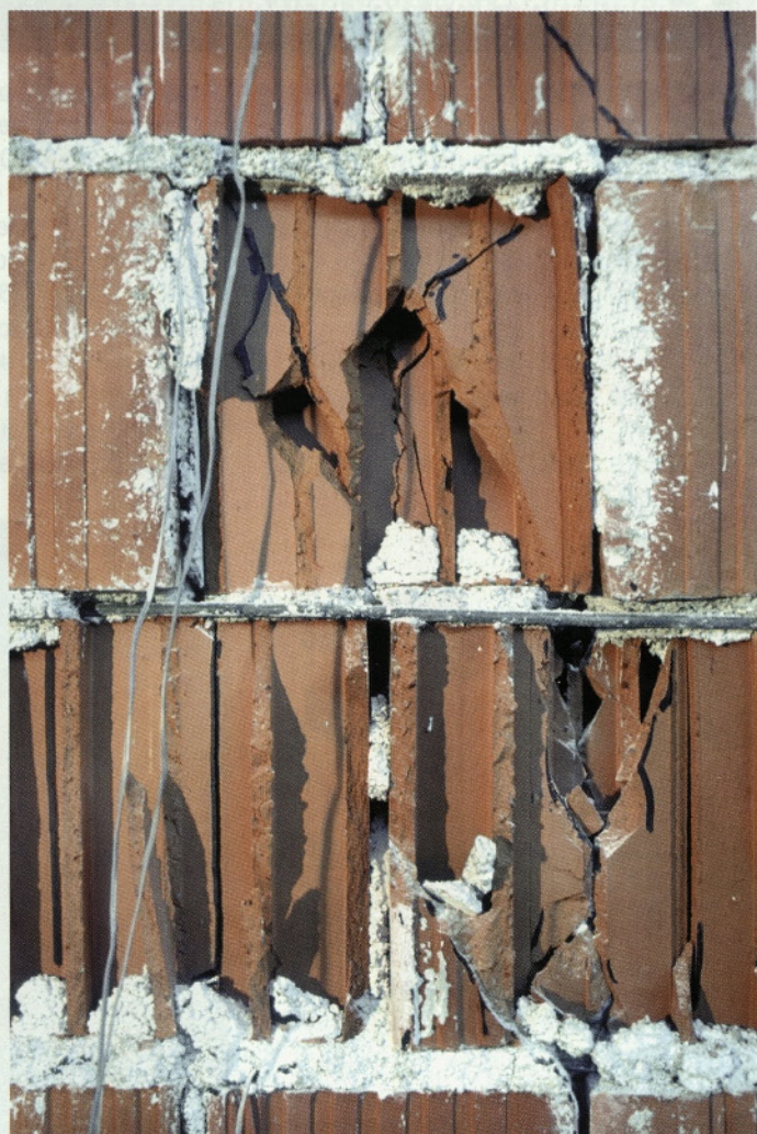
Slika 8 • Lokalno drobljenje sten in reber votlakov v osrednjem delu armiranega zidu
