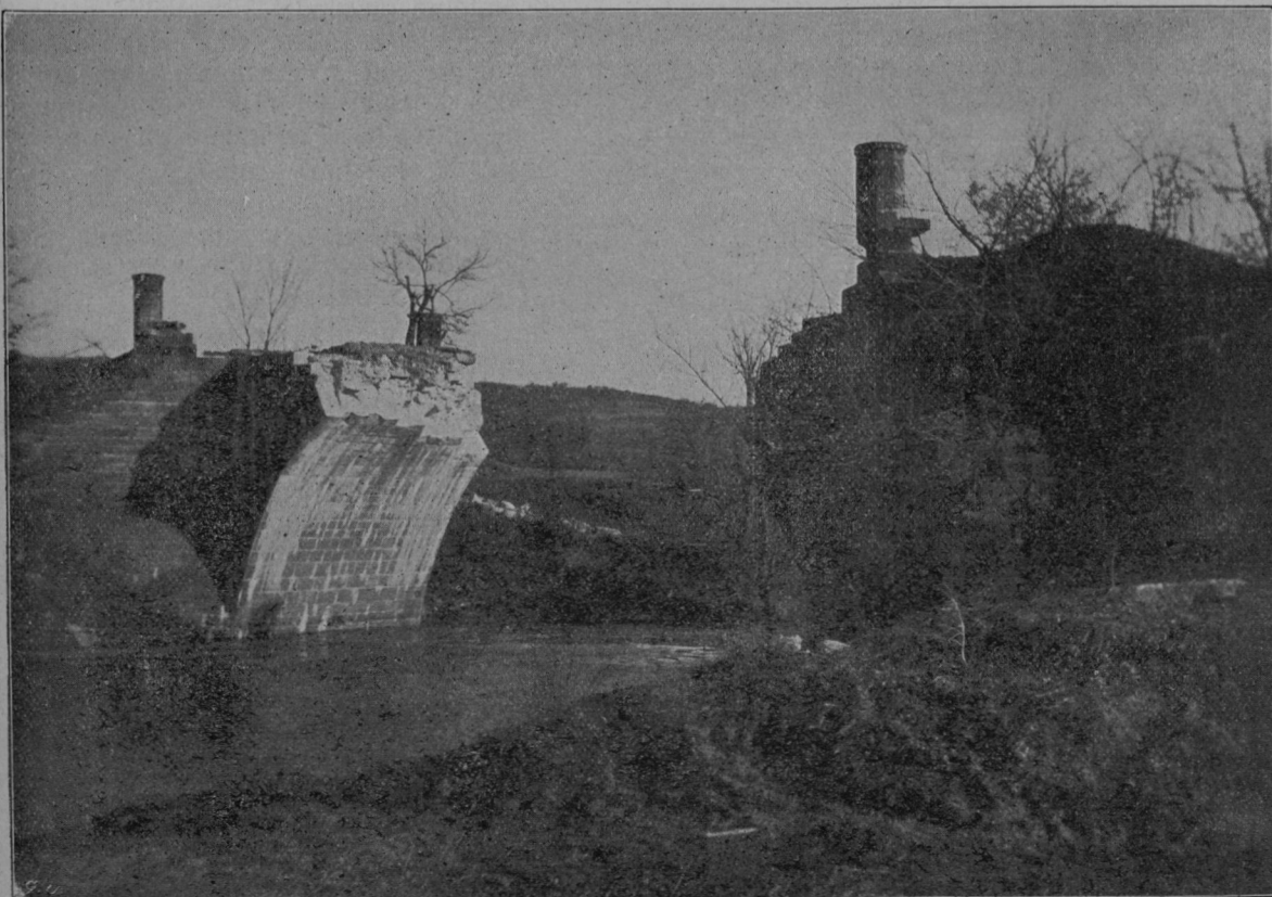
Iz Srbije: Porušeni zidani most v Županjih.
