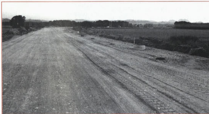
Gradbišče na povezovalni cesti na Turnišču; vzhodno od dvorca - med Pinčarjevim mlinom in Suho vejo.
