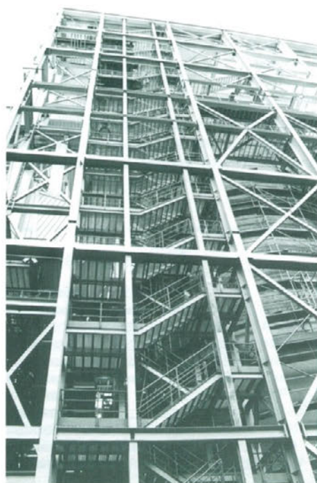
Vsa stopnišča in pohodne poti v čistilni napravi so obložili s pohodno pločevino.
