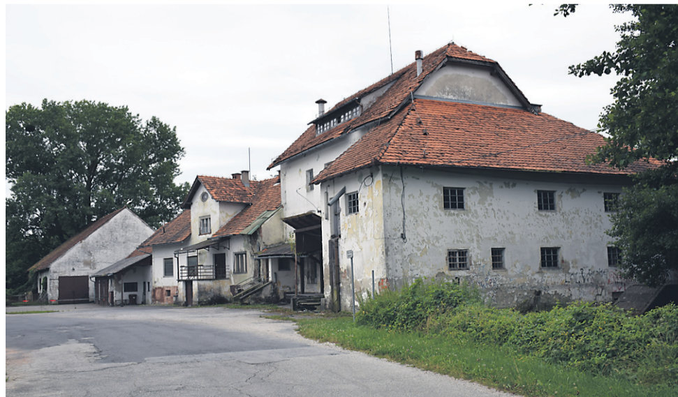
Svetnica Darja Koter je opozorila na katastrofalno stanje Koroščevega mlin, ki je zaradi propadanja za okolico zelo nevarno.
