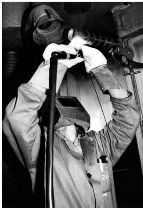
Varilstvo je kljub vsej avtomatizaciji in robotizaciji še vedno ročno delo, ki zahteva veliko spretnosti, izkušenj in kondicije. Foto: arhiv družine Tušek
