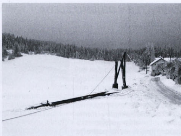
Odlomljen električni drog v Spodnjem Zavratacu. Foto: Janko Rupnik
