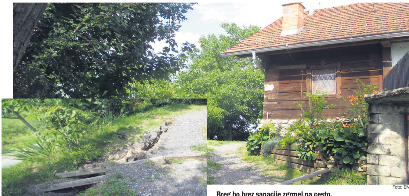
Breg bo brez sanacije zgrmel na cesto.
