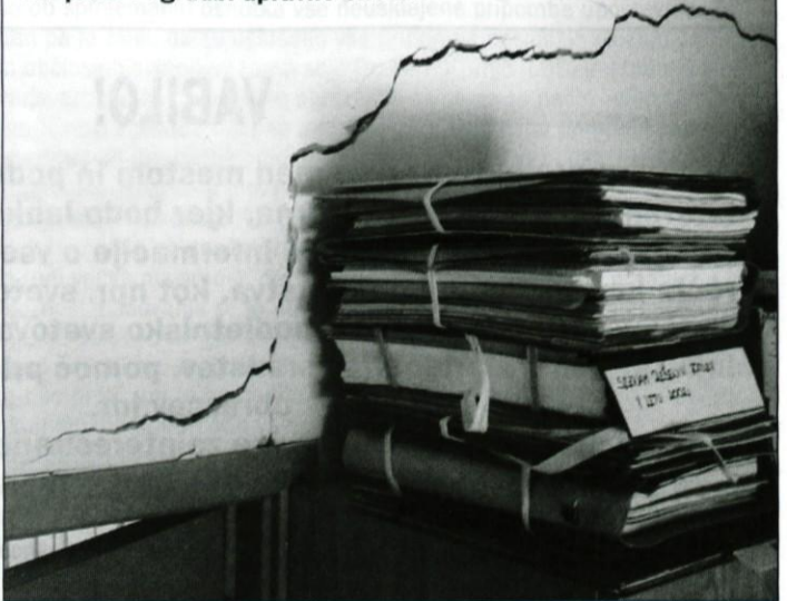
Razpoke v zgradbi upravne enote.
