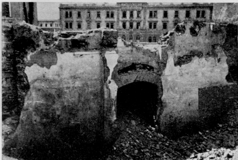
Sl. 7. Pogled na desni zid cerkve po porušenju hiše št. 4 v ulici 1. maja
