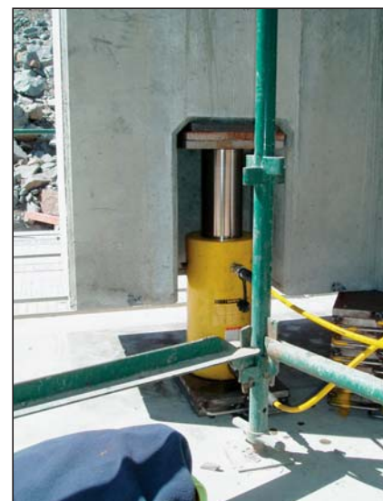
Slika 2. Hidravlični dvizni valj pod varnostno pregrado
