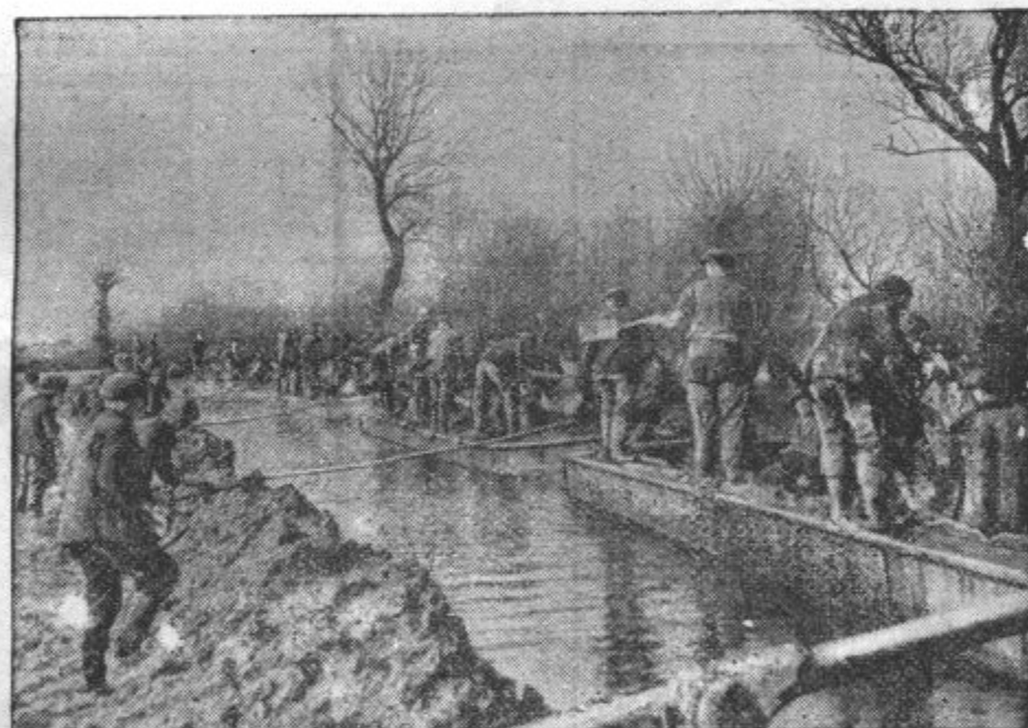
POSLEDICA SILNIH DEZEVLJ NA ANGLEŠKEM. Na tisoče mož je skušalo odvrniti poplavno katastrofo od Barwaya zadnji teden. Toda sila vode je na koncu zmagala. Čez podrte jezove se je razlila po zemlji navzlic jeklenim čolnom, s katerimi so jo skušali zadržati in zajeziti
