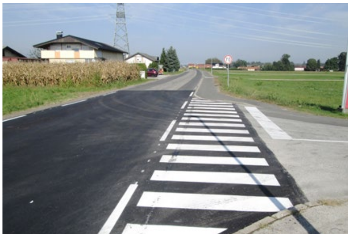
Obnova lokalne ceste v Pobrežju od križišča za podjetje Sveča proti Vidmu. Foto: arhiv občinske uprave
