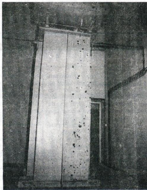
Med vojno za samostojno Slovenijo poškodovan modulačijski transformator 600 kW radijskega oddajnika v Domžalah
