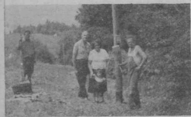
Del telefonske linije od Janč proti Besnici. Na desni stoji predsednik odbora za napeljavo telefona Janez Končar iz Gaberja, v sredini članica odbora Helena Friškovec z Janč, poleg nje pa vodilni monter Jože Skubic iz Sostrega, ki je sodeloval pri tehničnih delih napeljave.
