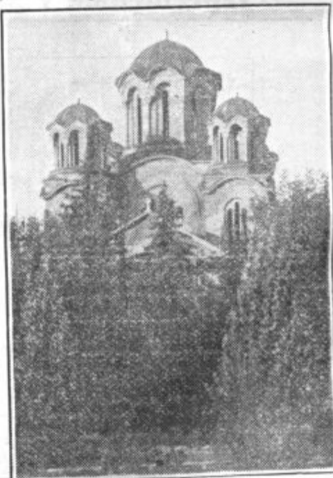
Pravoslavna cerkev v Ljubljani bo v kratkem dograjena. Gradnja krasne stavbe v bizantinskem slogu vzbuja pozornost Ljubljancem in zlasti še tujcev. (Foto Stane Ribnikar.)
