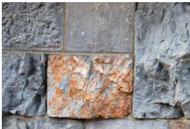
Slika 14: Tektonske drse v bloku podpeškega apnenca na fasadi Narodne in univerzitetne knjižnice. Foto: Matevž Novak.
