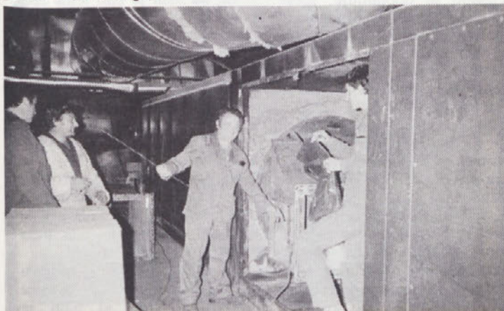
PROIZVODNJA IV. – Najzahtevnejša, pa tudi najinteresantnejša dela so opravili v lakirnici. Tokrat vzdrževalce lahko še posebej pohvalimo, saj so prvič opravili remont brez strokovnjakov iz DÜRR. Najzahtevnejša dela so bila opravljena na DC gorilnikih, na liniji KTL ter na liniji predlaka. V celoti so bili pregledani in zamenjani obrabljeni deli na liniji visečega transporta in ostalih transportnih napravah. Izvršena je bila zamenjava obtočnih črpalk na liniji flutacije, zamenjani so grelci toplega zraka v kabini lakiranja. Pomembno delo je bilo opravljeno na zamenjavi konstrukcije na odpadnih vodah.
