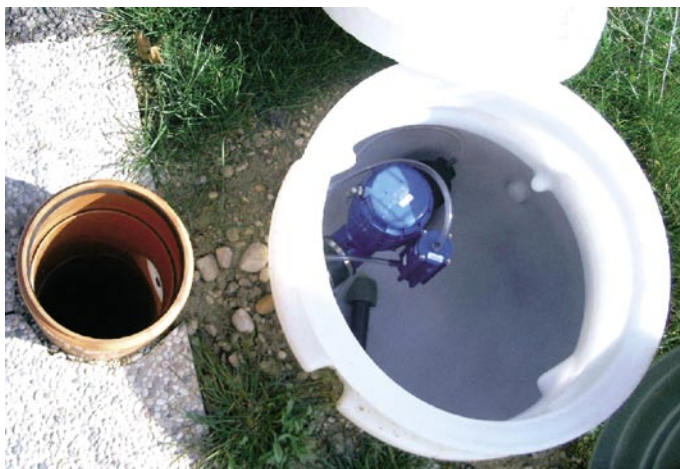
Slika 8 • Pogled na pokrov standardnega jaška ROEVAC
